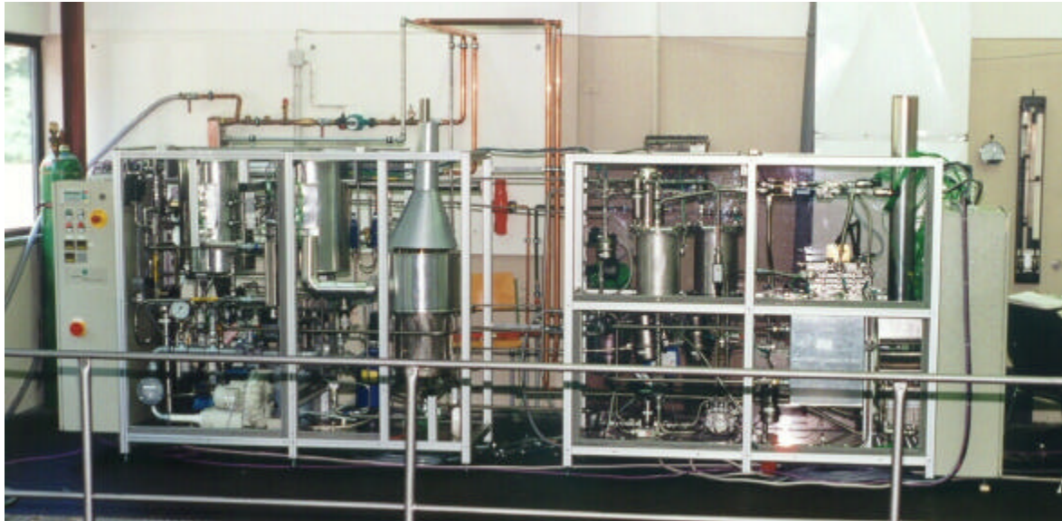
Abb. 14: Erdgasbetriebene 5 kW PEMFC-Hausenergieanlage an der FH Ulm entwickelt vom ZSW Ulm und dem FhG ISE Freiburg
